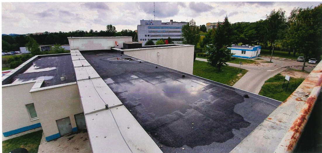
Fot. 9. Widok na dach łącznika i budynku SOR z balkonu budynku głównego szpitala
